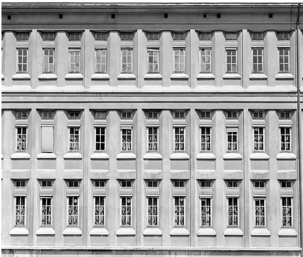
Bâtiment D : fenêtres de la façade sur la cour, avant restauration.
