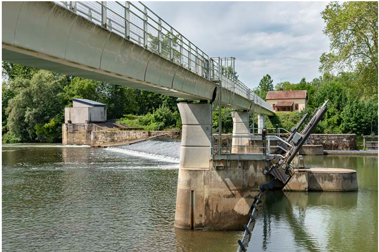
Vue de détail sur les clapets.
