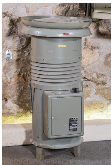
Redresseur IREM. Phot. Pierre-Marie Barbe-Richaud IVR26_20238900442NUC4A
