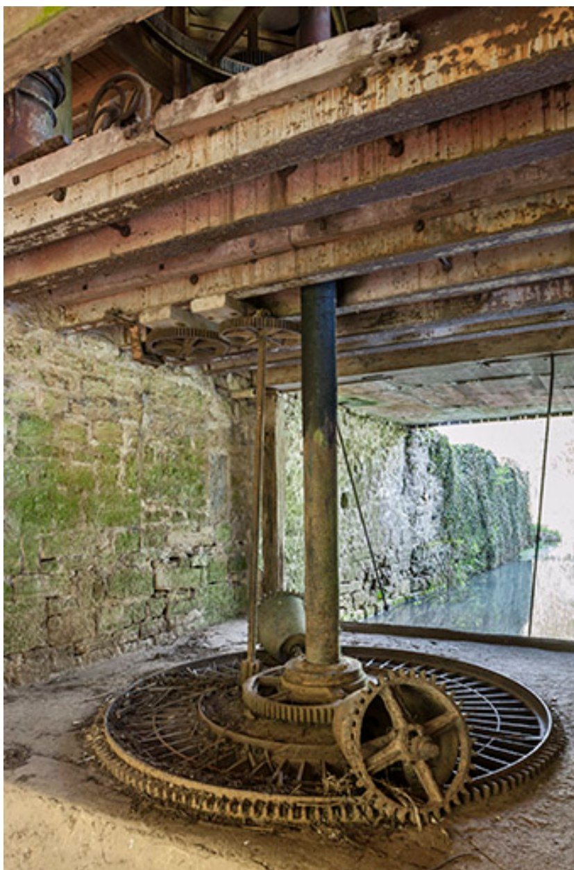
Partie supérieure de la turbine.
