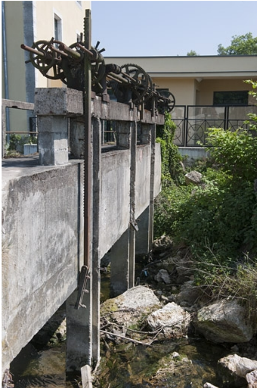
Système de vannage du bief de dérivation.
