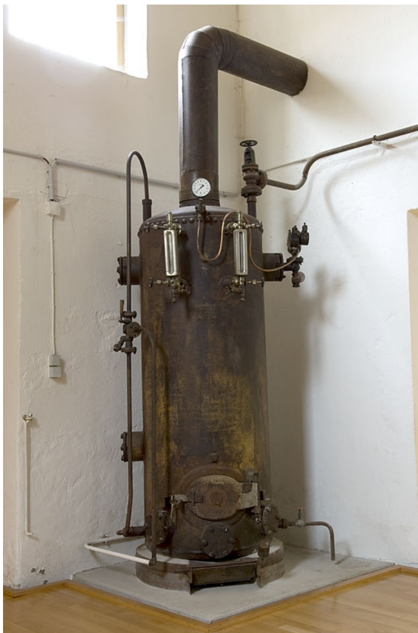
Salle de distillation. Chaudière Thiébaud (Trévillers).
