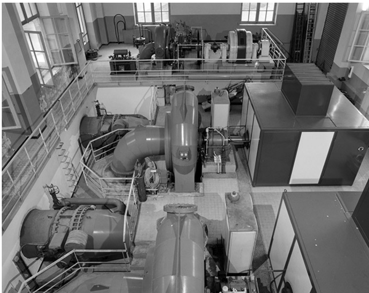
Intérieur de la centrale.
