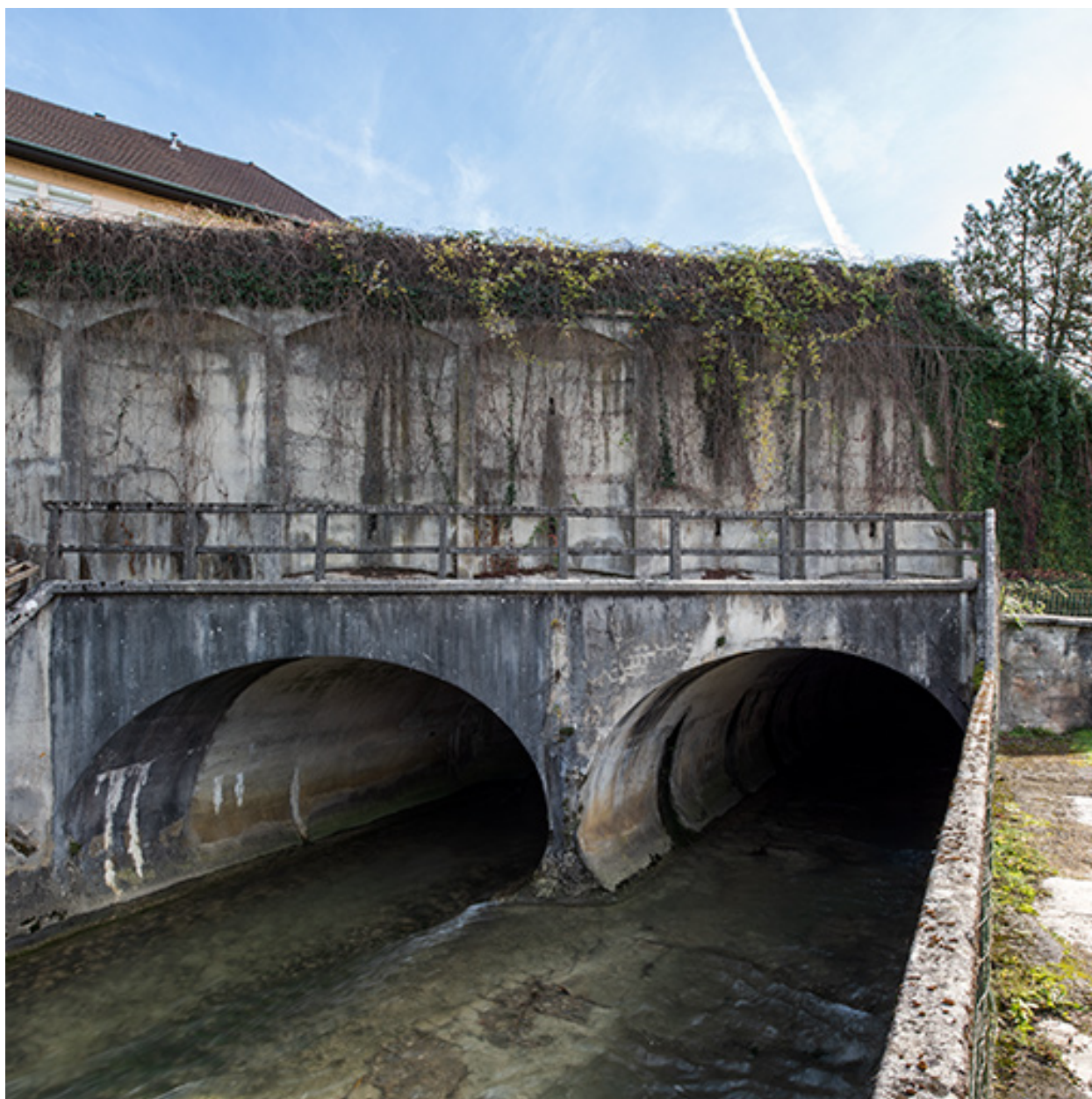
Canalisations de sortie.
