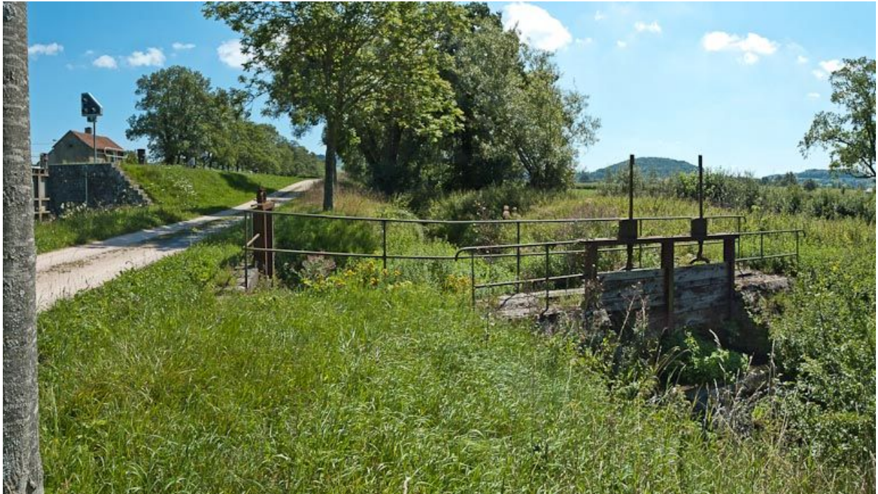
Vue des vannes de prise d'eau.
