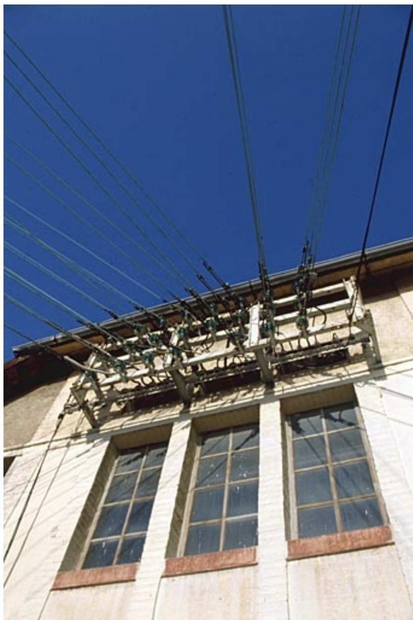
Détail du transformateur : départ de fils électriques.
