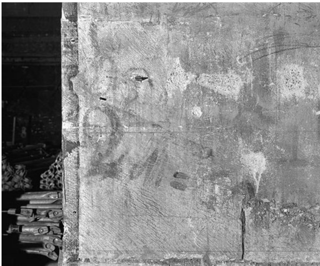
Choeur, mur nord : graffiti.
