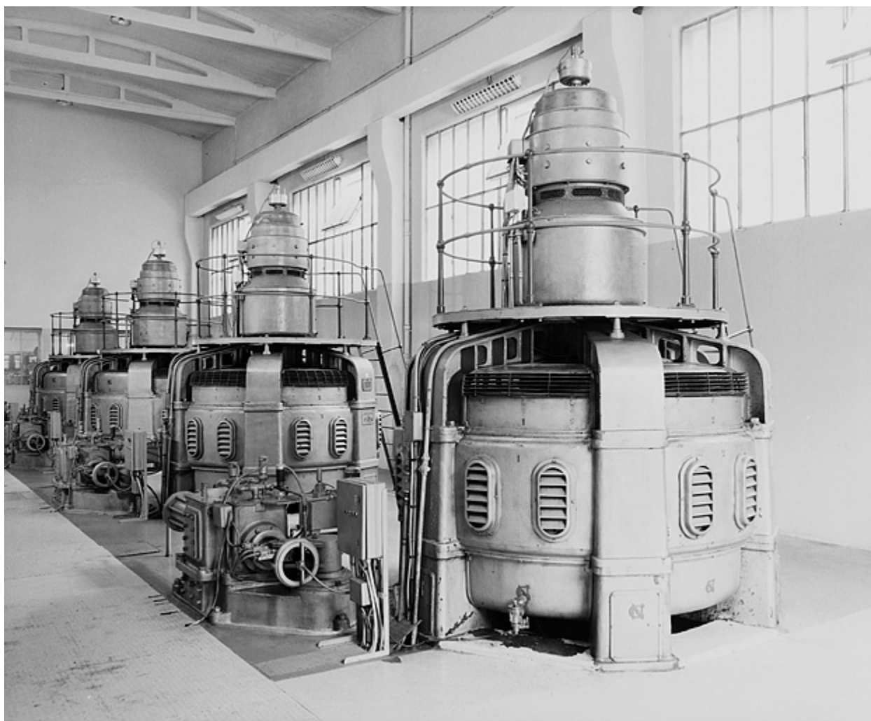
Vue d'ensemble des alternateurs.
