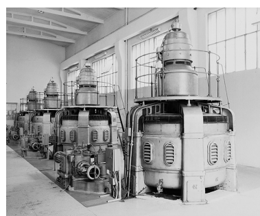
Vue d'ensemble des alternateurs. Phot. Jérôme Mongreville IVR43_19923900524X
