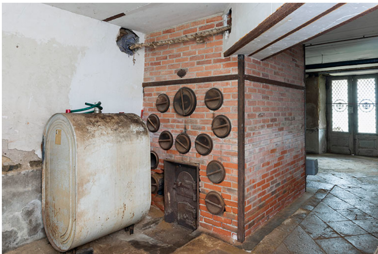
L'ancien chauffage centrale du château.
