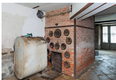
L'ancien chauffage centrale du château. Phot. Jérôme Mongreville IVR43_20167000841NUC4A
