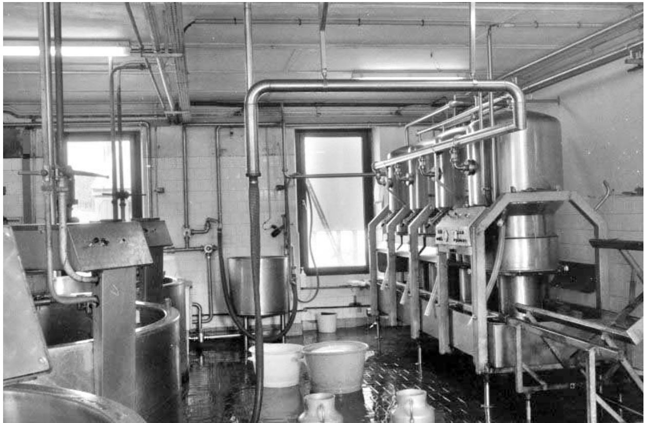
Installation de soutirage.
