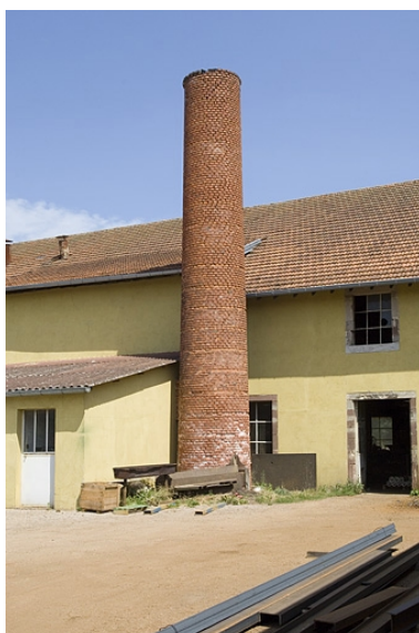
Cheminée de la machine à vapeur. Phot. Jérôme Mongreville IVR43_20067000668NUCA
