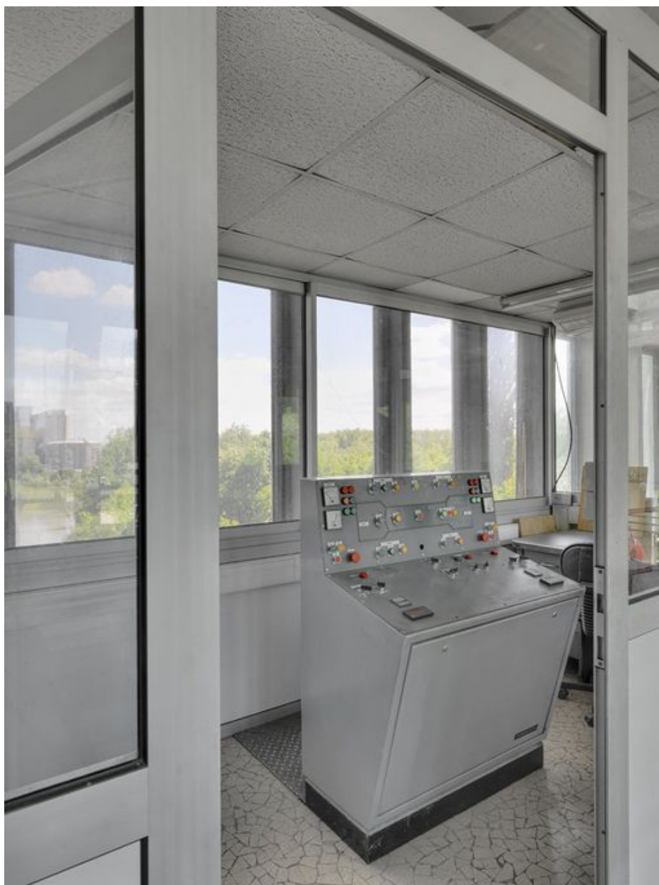
Vue intérieure de l'ancien poste de commande.
