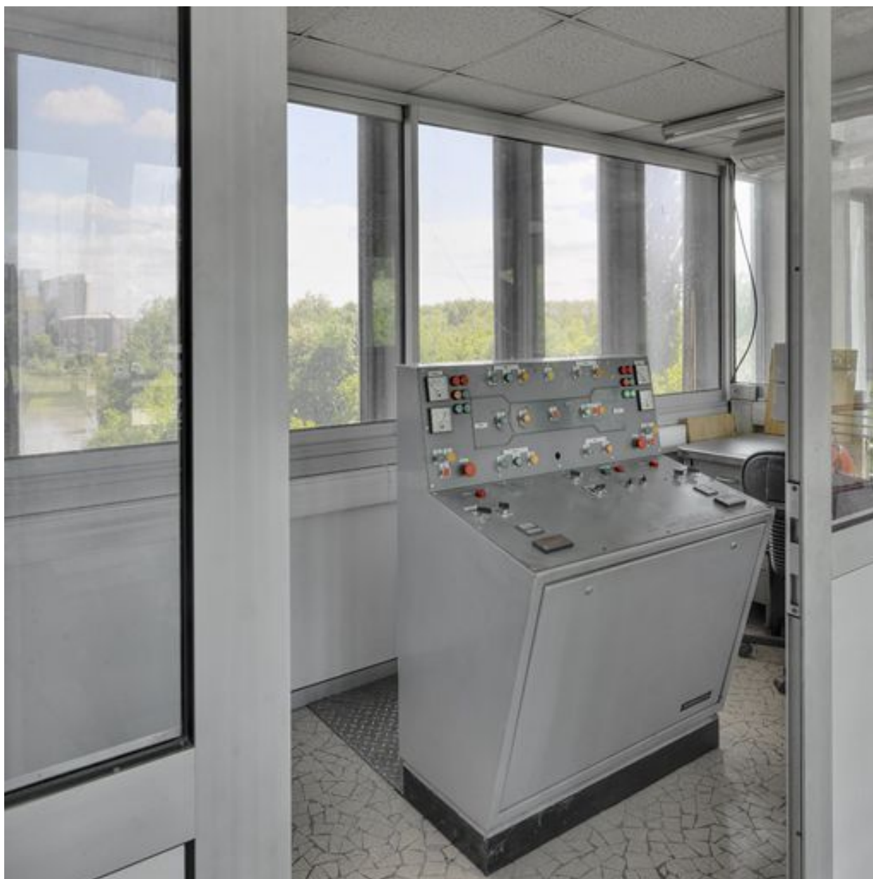
Vue intérieure de l'ancien poste de commande.
