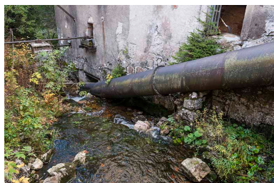
Conduite forcée de la turbine. Phot. Jérôme Mongreville IVR43_20152501818NUC4A
