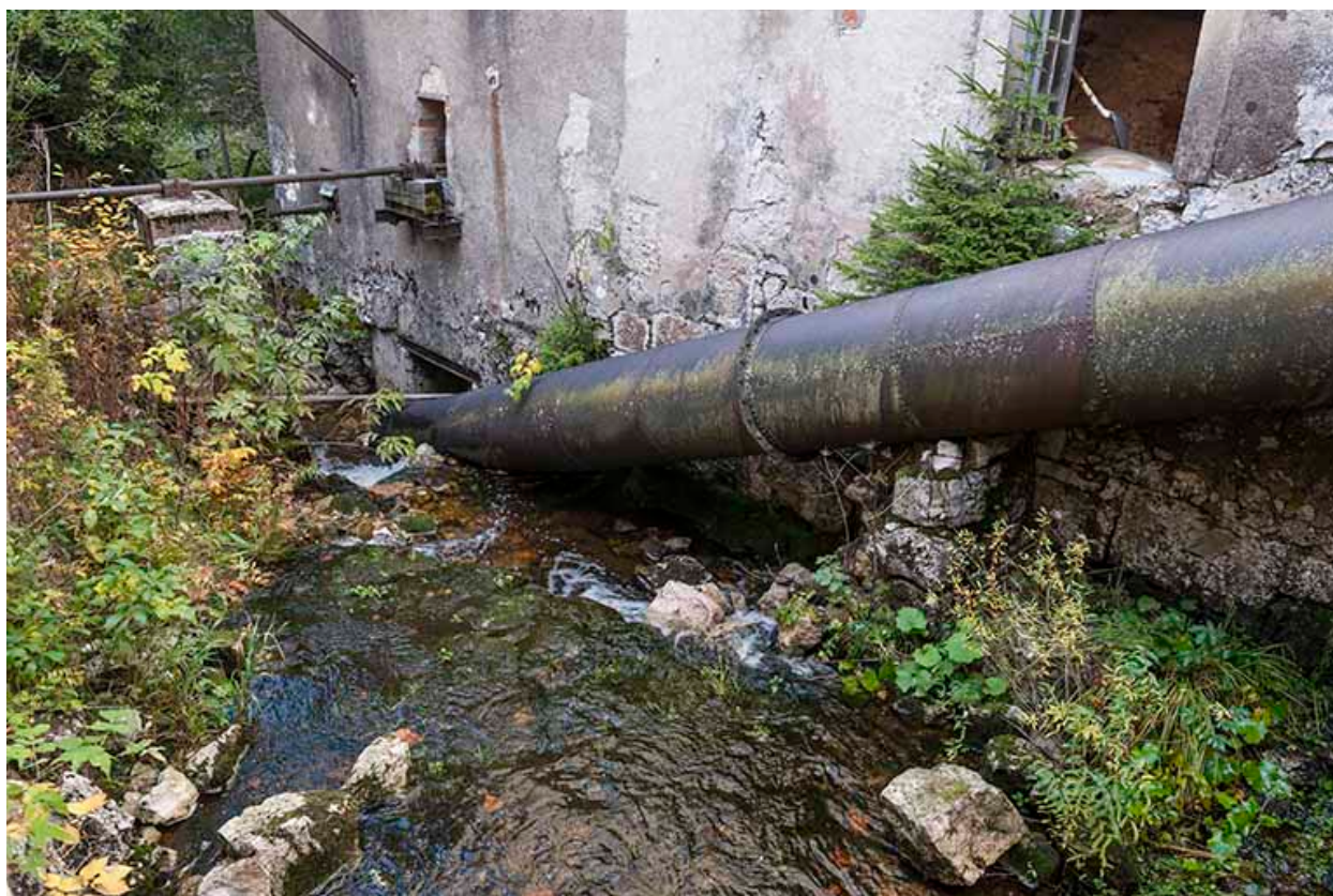
Conduite forcée de la turbine.
