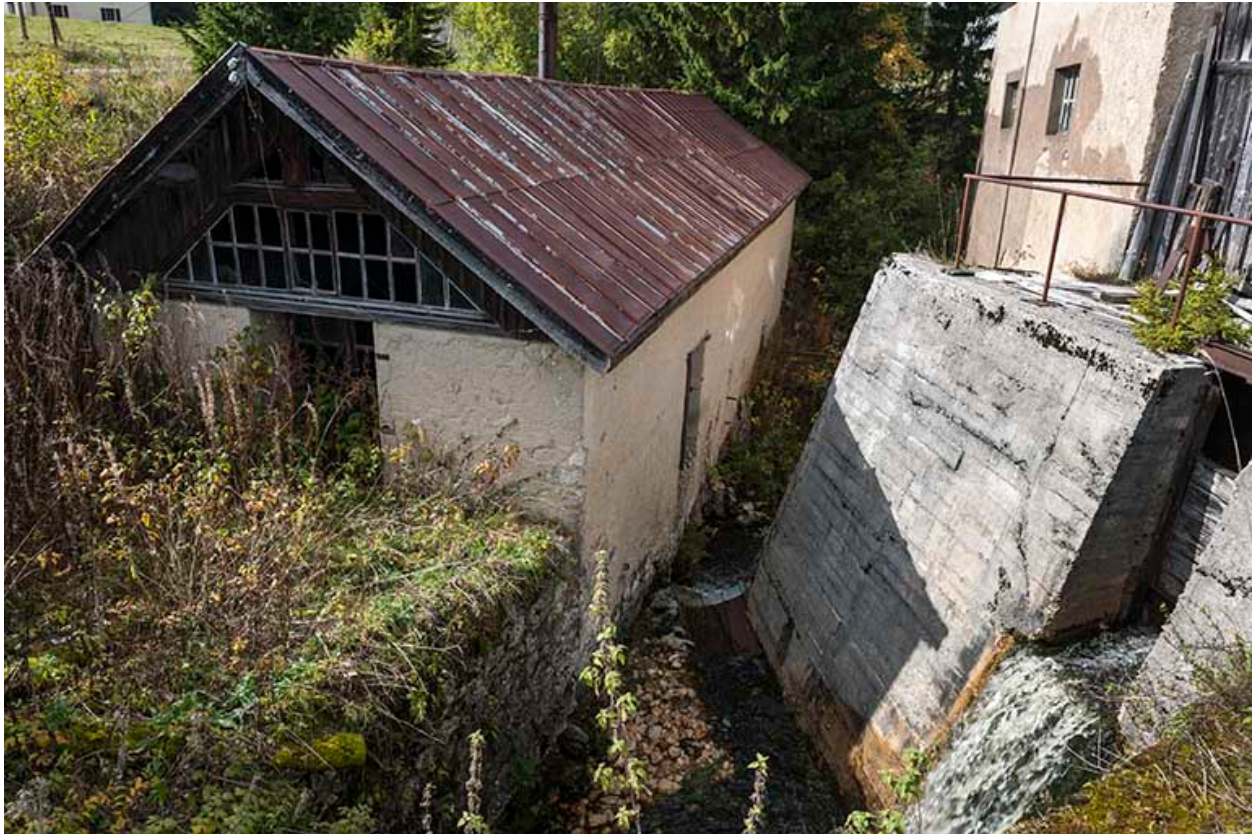
Salle de la machine à vapeur.
