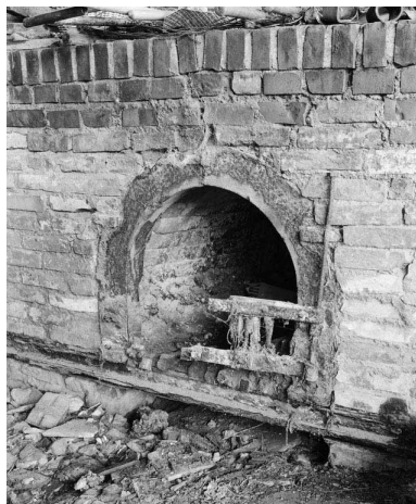
Détail du four : bouche d'enfournement du bois. Phot. Michel Thierry IVR26_19792101529X
