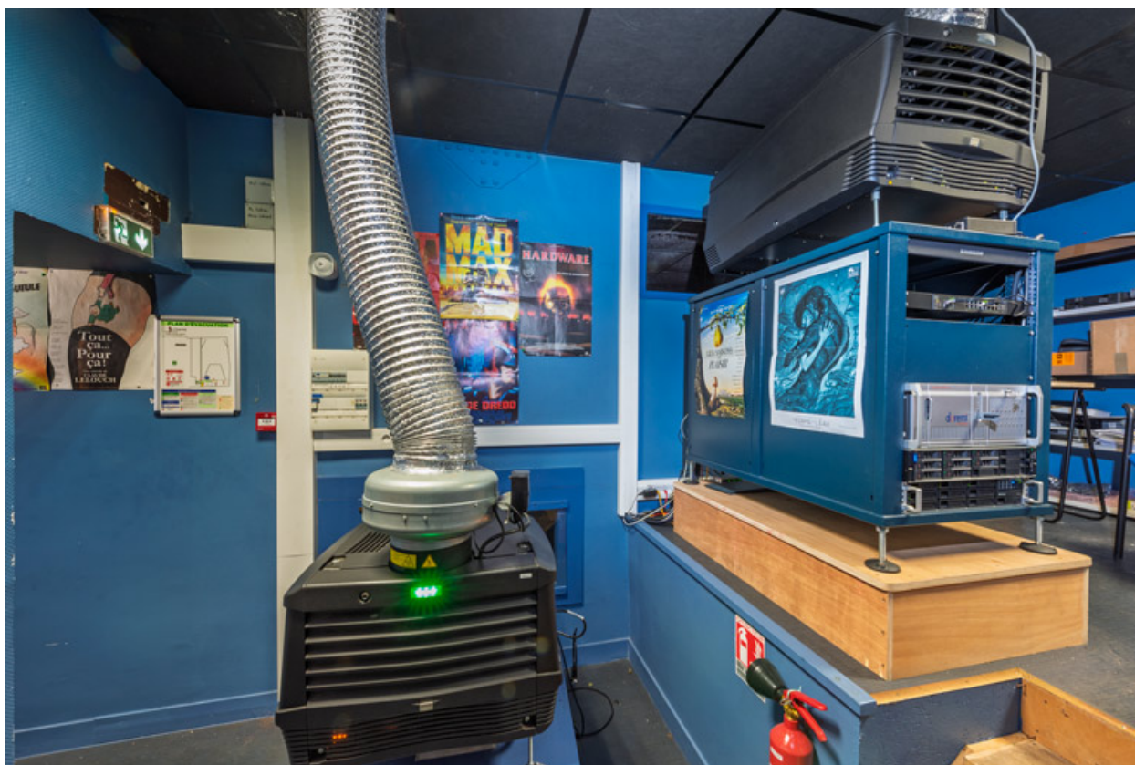
Cabine de projection : projecteurs Barco DP2K12C.
