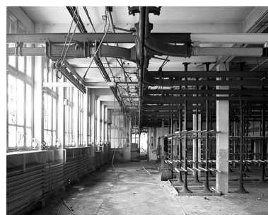
Magasin et monorail. Phot. Yves Sancey IVR43_19932500030X
