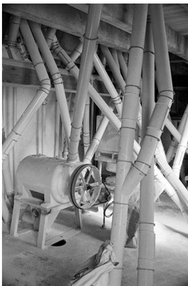
Soufflerie du transport pneumatique. Phot. Laurent Poupard IVR43_19883900693Z
