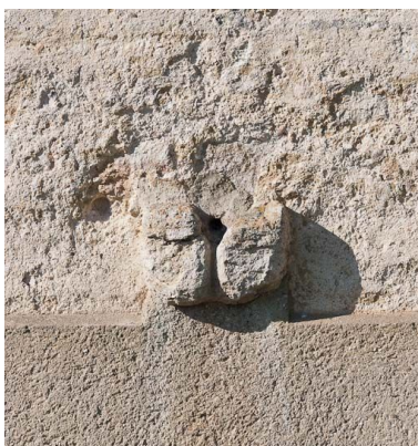
Vue d'une pierre d'écoulement de l'évier. Phot. Pierre-Marie Barbe-Richaud IVR26_20112104021NUC2AQ
