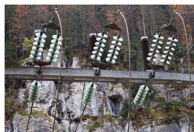
Transformateur : isolateurs. Phot. Yves Sancey IVR43_20122502159NUC2A
