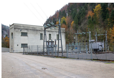
Centrale (façade antérieure) et transformateur. Phot. Yves Sancey IVR43_20122502158NUC2A
