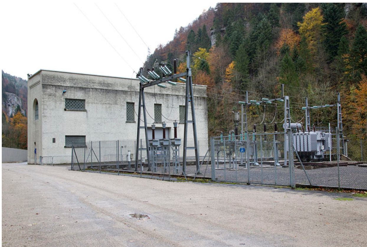
Centrale (façade antérieure) et transformateur.
