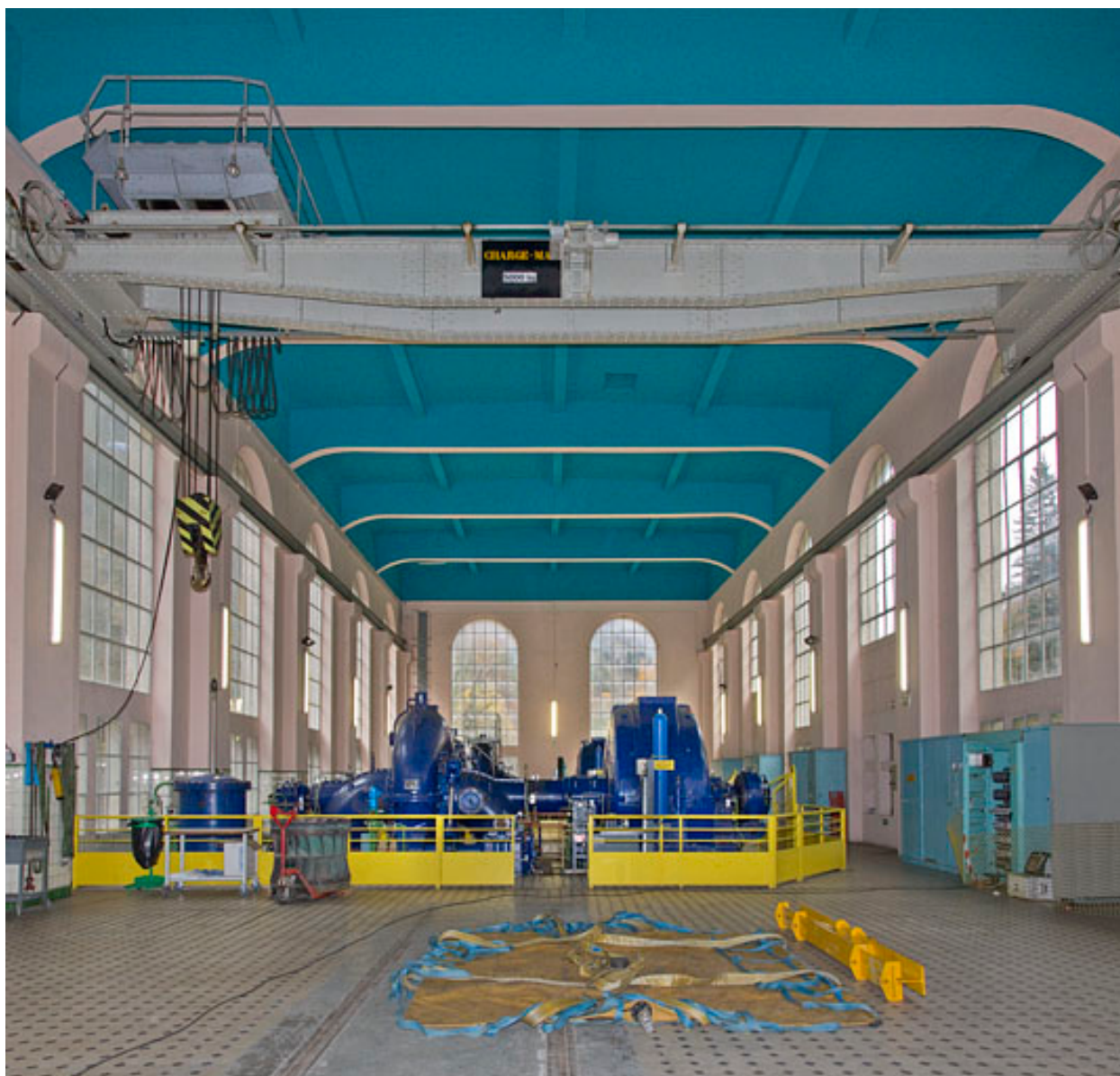
Centrale : intérieur de la salle des machines.
