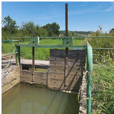
Vannes de régulation sur la rigole. Phot. Thierry Kuntz IVR26_20122102085NUC4A
