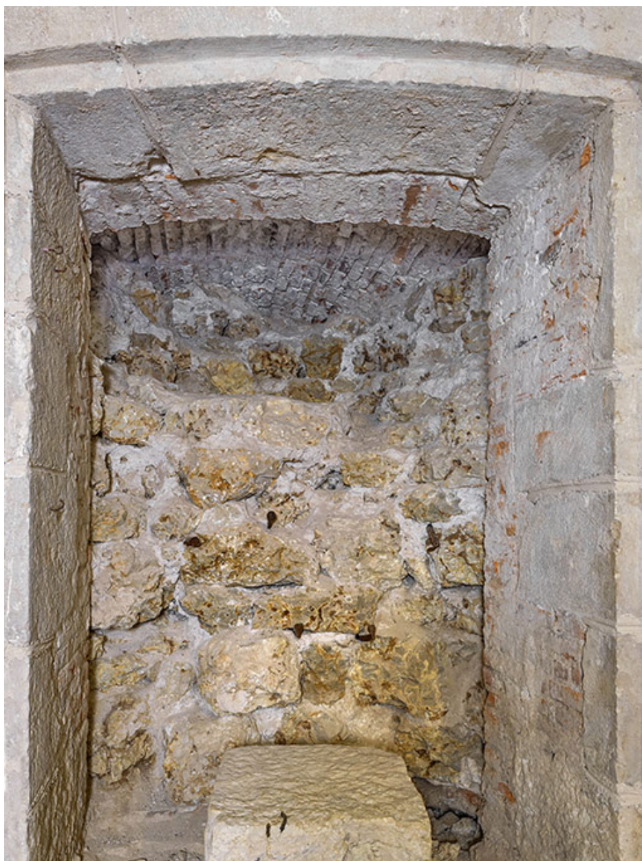
Tour Notre-Dame : ouverture obstruée.
