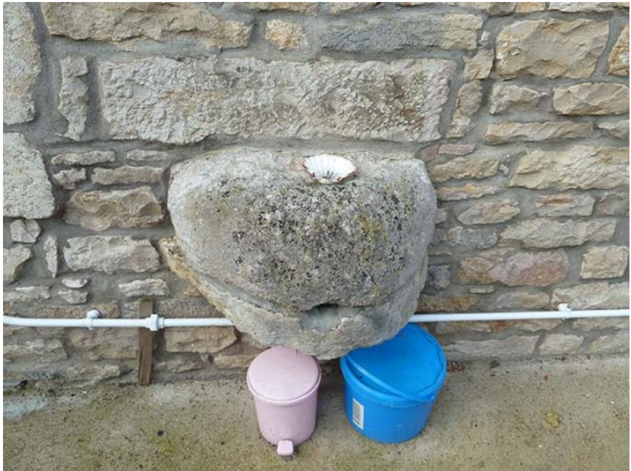
"Goulotte" d'évacuation de l'évier intérieur
