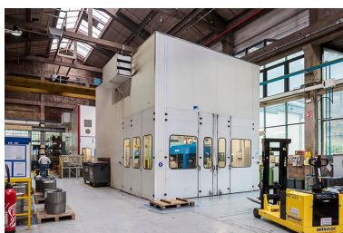
Presse de l'atelier de tôlerie. Phot. Jérôme Mongreville IVR43_20162500190NUC4A
