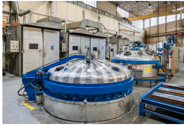
Autoclaves (imprégnation de vernis des stators). Phot. Jérôme Mongreville IVR43_20162500155NUC4A
