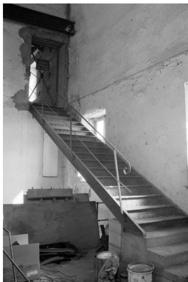
Salle des machines à vapeur (b3) : escalier. Phot. Laurent Poupard IVR43_19883900361Z
