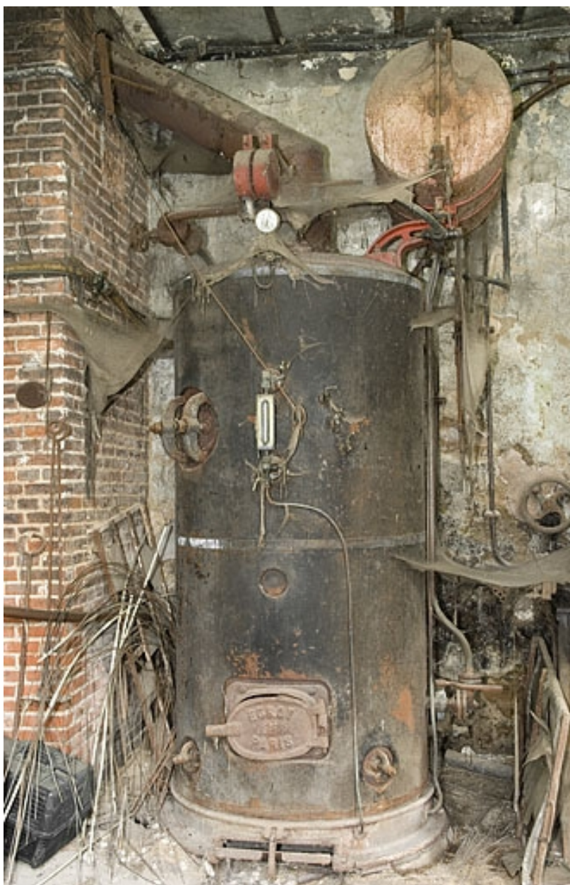
Atelier de distillation. Chaudière Egrot.
