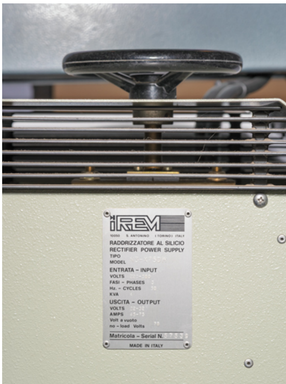
Plaque signalétique du redresseur IREM.
