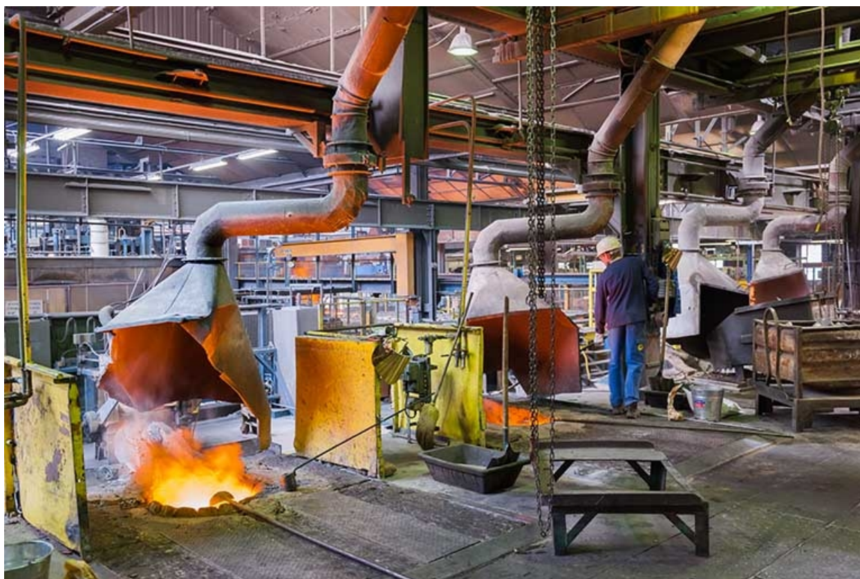
Partie supérieure des fours à induction.
