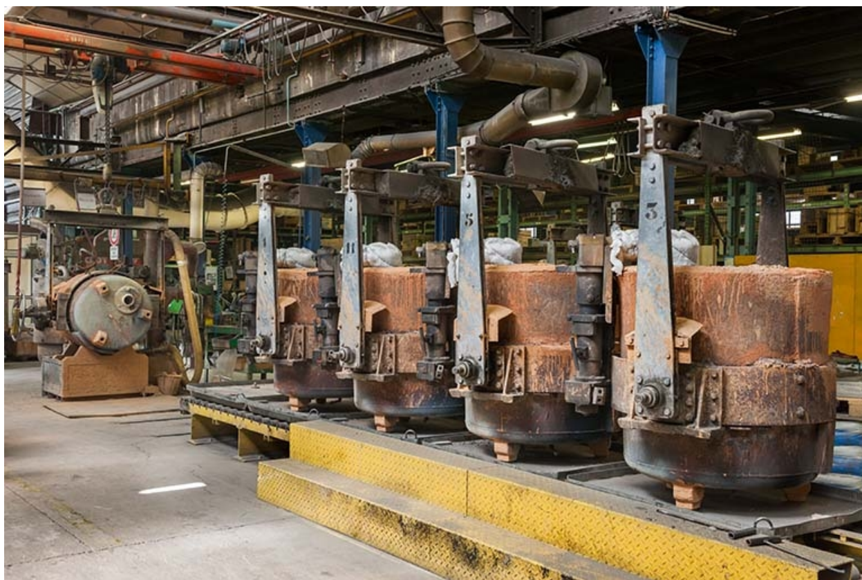
Poches de coulée avant réfection (1).
