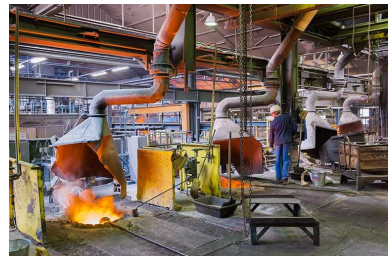
Partie supérieure des fours à induction. Phot. Jérôme Mongreville IVR43_20132500956NUC4A
