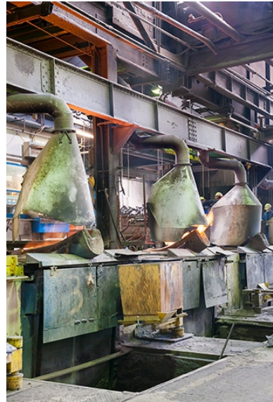
Fours à induction. Phot. Jérôme Mongreville IVR43_20132500949NUC4A
