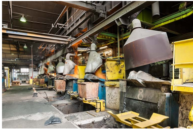
Batterie de fours à induction (2). Phot. Jérôme Mongreville IVR43_20132500952NUC4A
