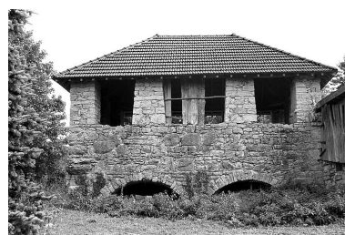
Four : ouvertures du foyer. Phot. Laurent Poupard IVR43_19933900545Z
