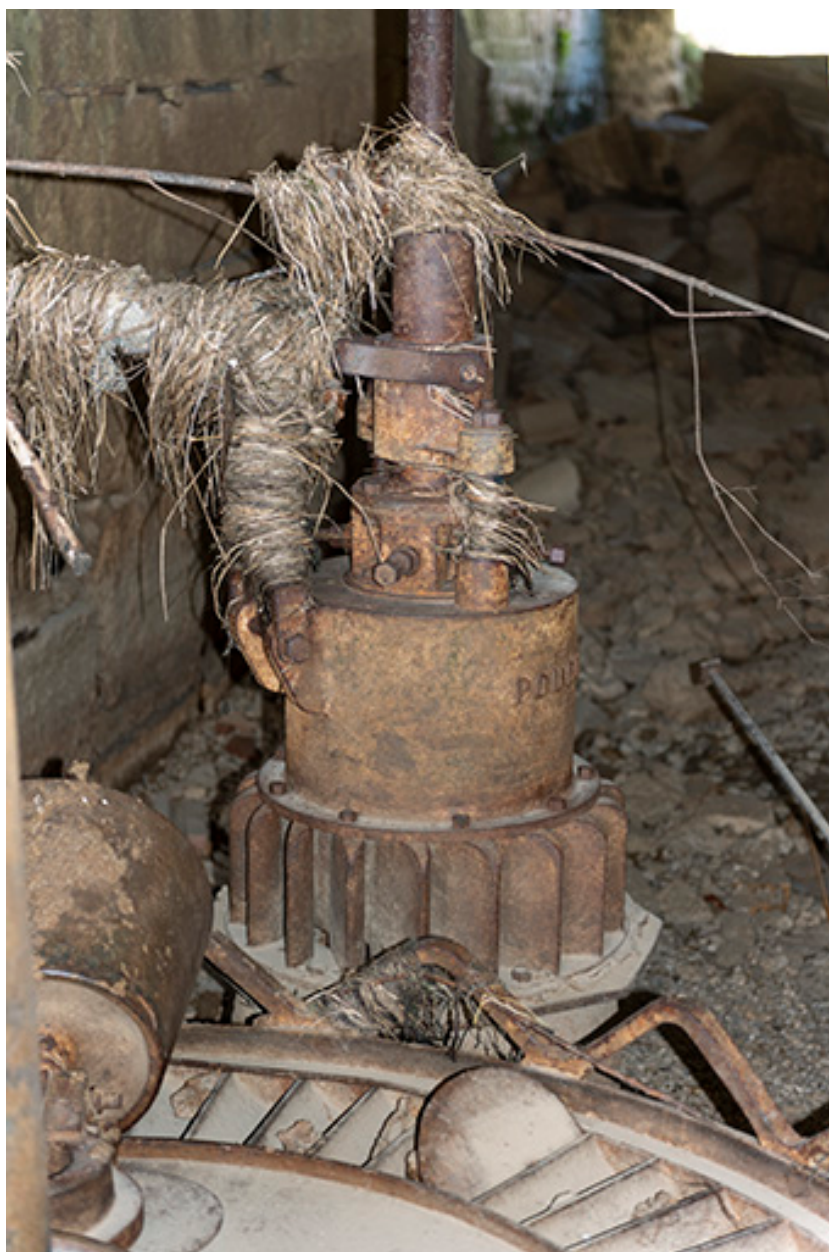
Moulin : transmission de la commande d'admission d'eau.
