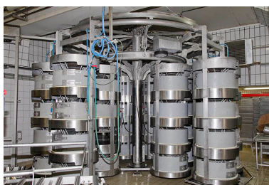
Groupe de pressage. Phot. Yves Sancey IVR43_20132501182NUC2A
