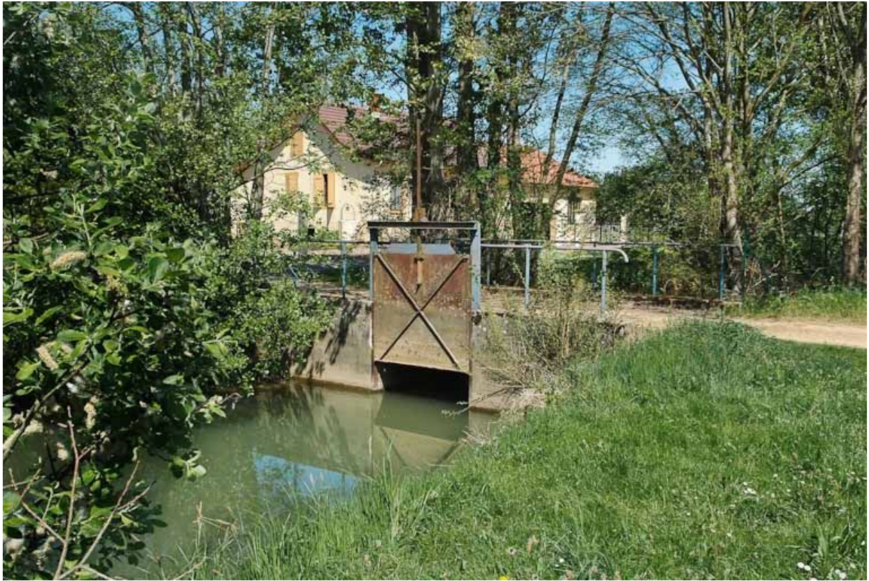
Vue d'ensemble : vanne.
