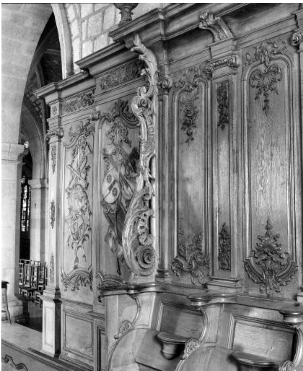
Détail : panneaux 2 -3 et stalles II-III.
