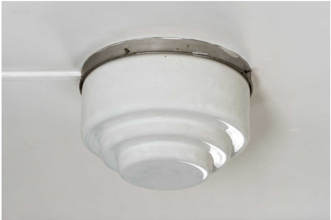
Galerie vitrée : luminaire d'applique.
