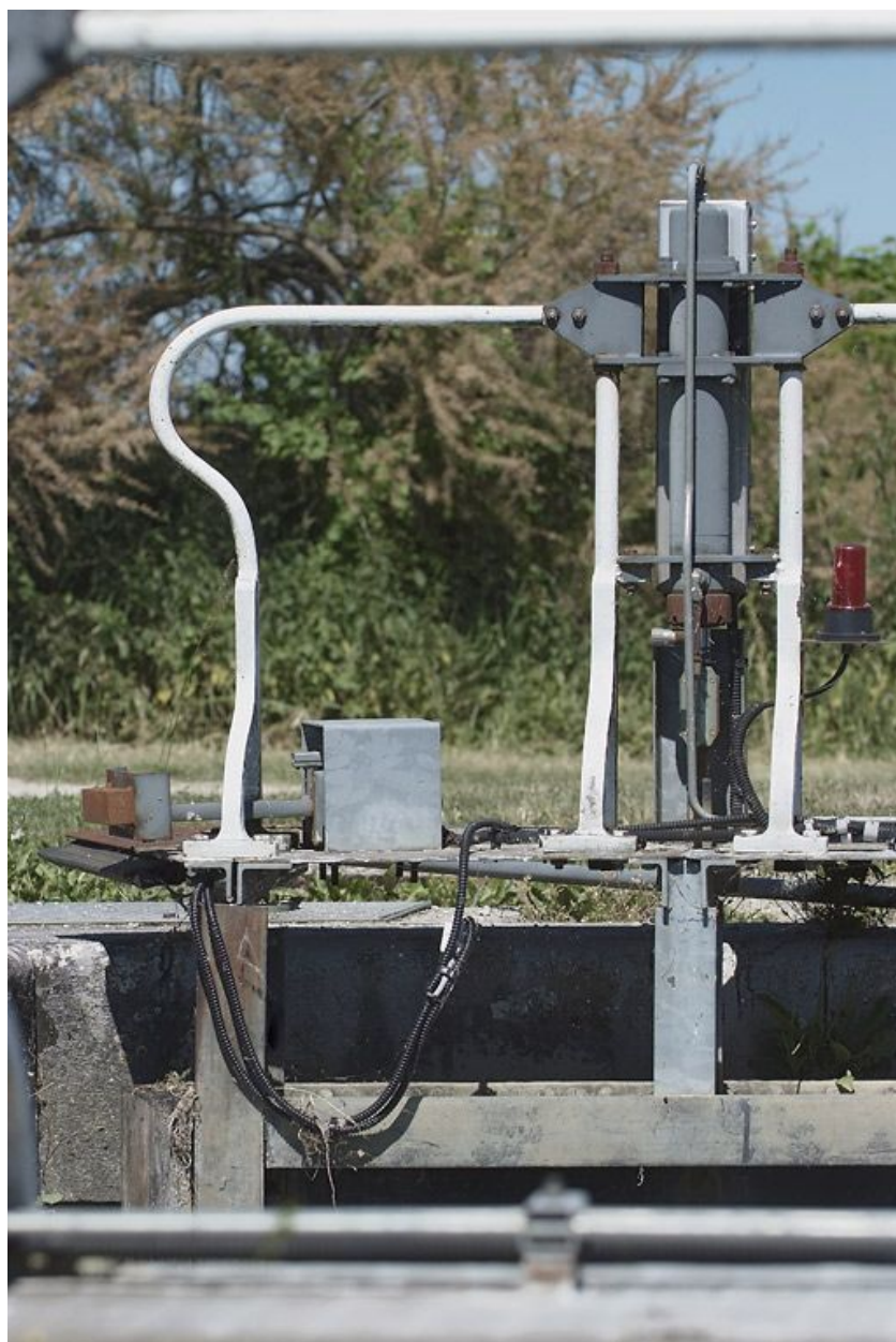
Détail du système d'automatisation des portes.
