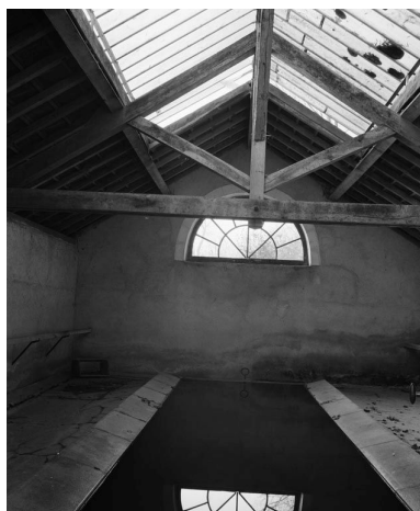
Vue intérieure. Phot. non renseigné IVR26_19728901287X
