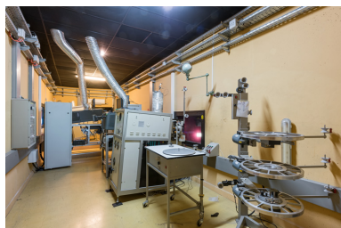
Cabine de projectionniste (projecteurs des salles 7 et 8). Phot. Pierre-Marie Barbe-Richaud IVR26_20238900429NUC4A
