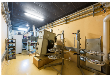
Cabine de projectionniste (projecteurs des salles 7 et 8). Phot. Pierre-Marie Barbe-Richaud IVR26_20238900456NUC4A
