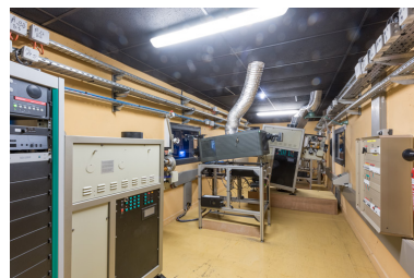
Cabine de projectionniste (projecteurs des salles 5 et 6). Phot. Pierre-Marie Barbe-Richaud IVR26_20238900455NUC4A
