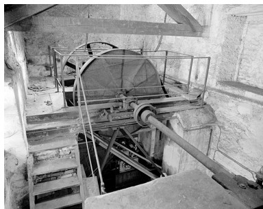
Système de transmissions de la turbine Kaplan. Phot. Yves Sancey IVR43_19999000240X
