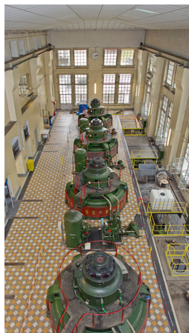
Centrale hydroélectrique : vue plongeante sur la salle des machines. Phot. Yves Sancey IVR43_20122502010NUC2A
