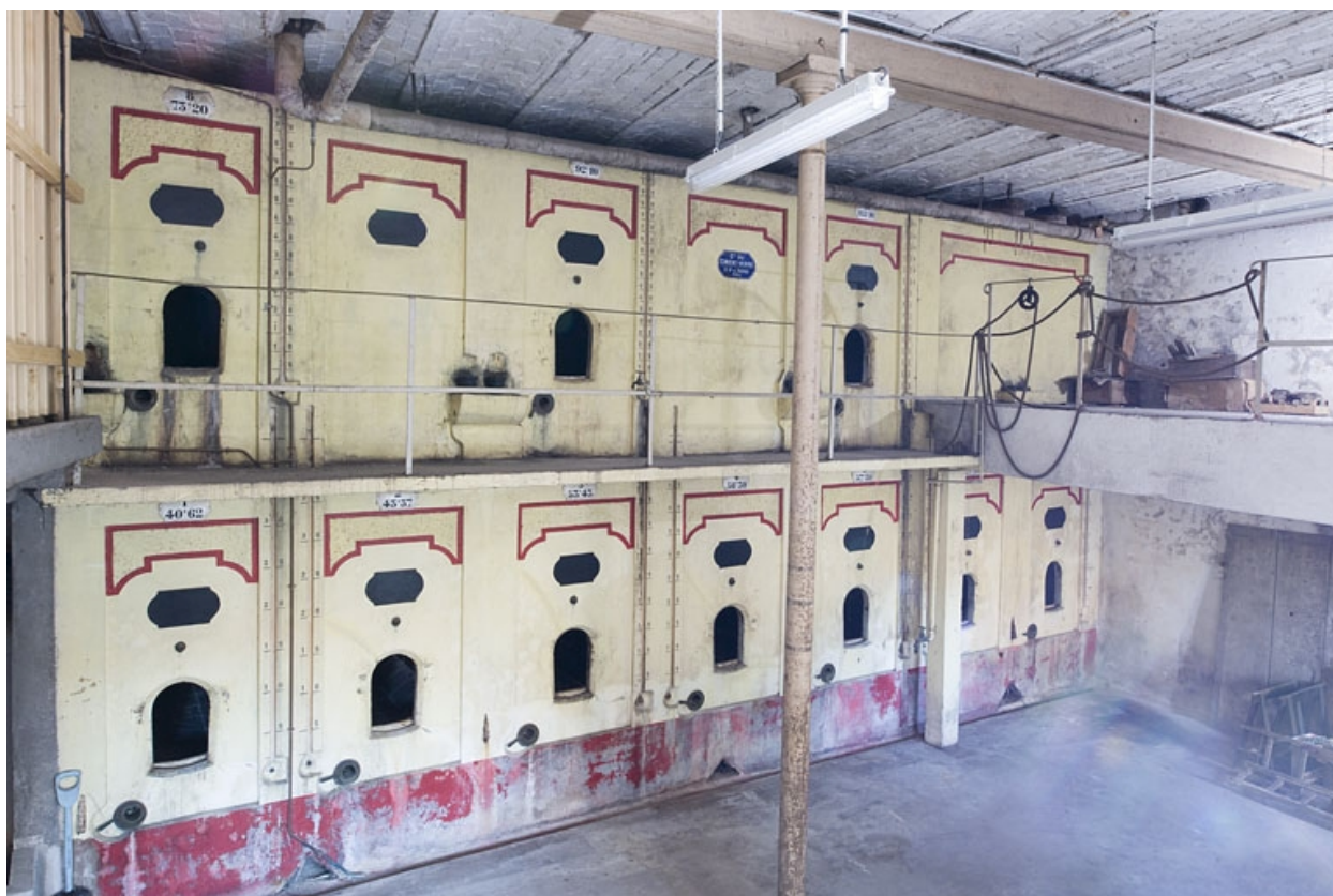
Intérieur de l'entrepôt : vue d'ensemble des cuves.
