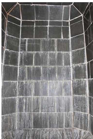
Intérieur d'une cuve. Phot. Marc Loukachine IVR43_20112502367NUC4A
