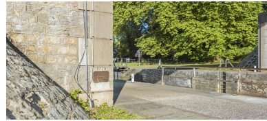
Repère de crue. Phot. Thierry Kuntz IVR26_20162101382NUC4A
