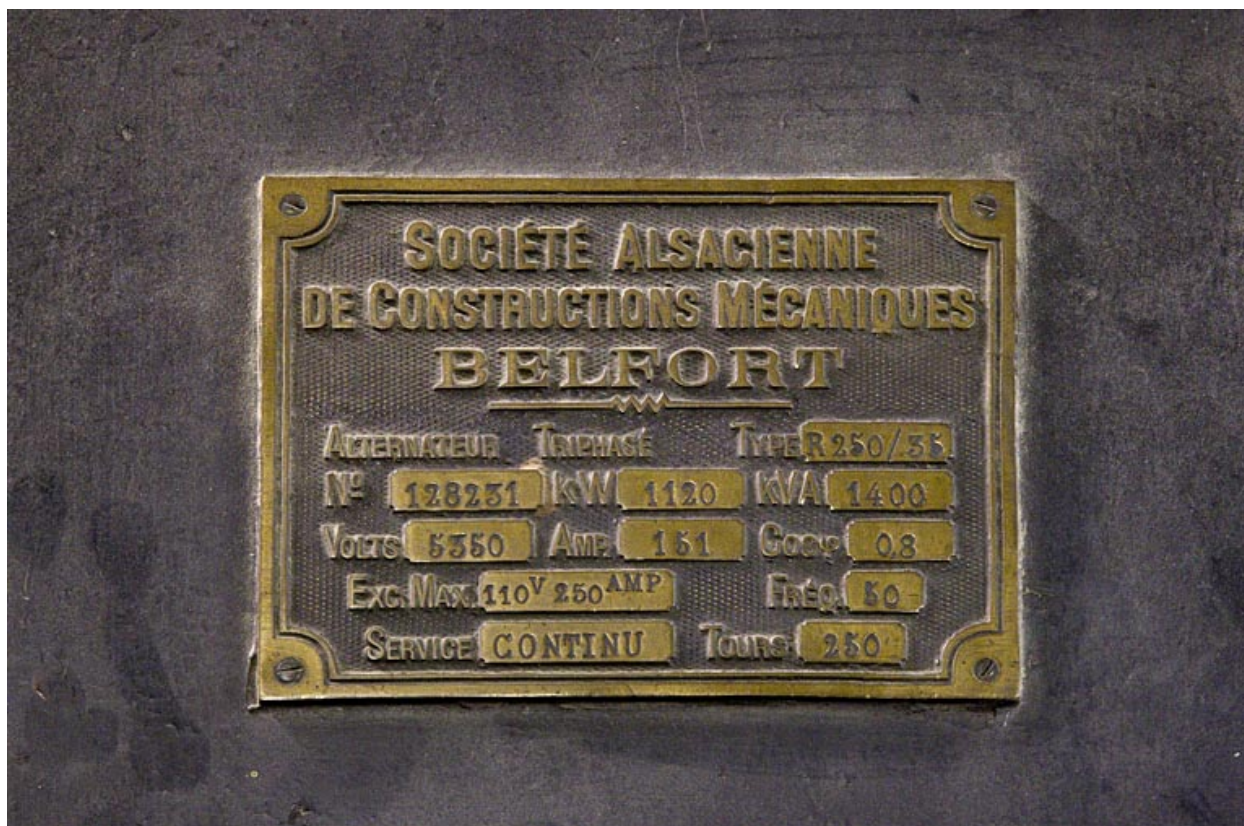
Centrale : plaque signalétique de l'alternateur.
