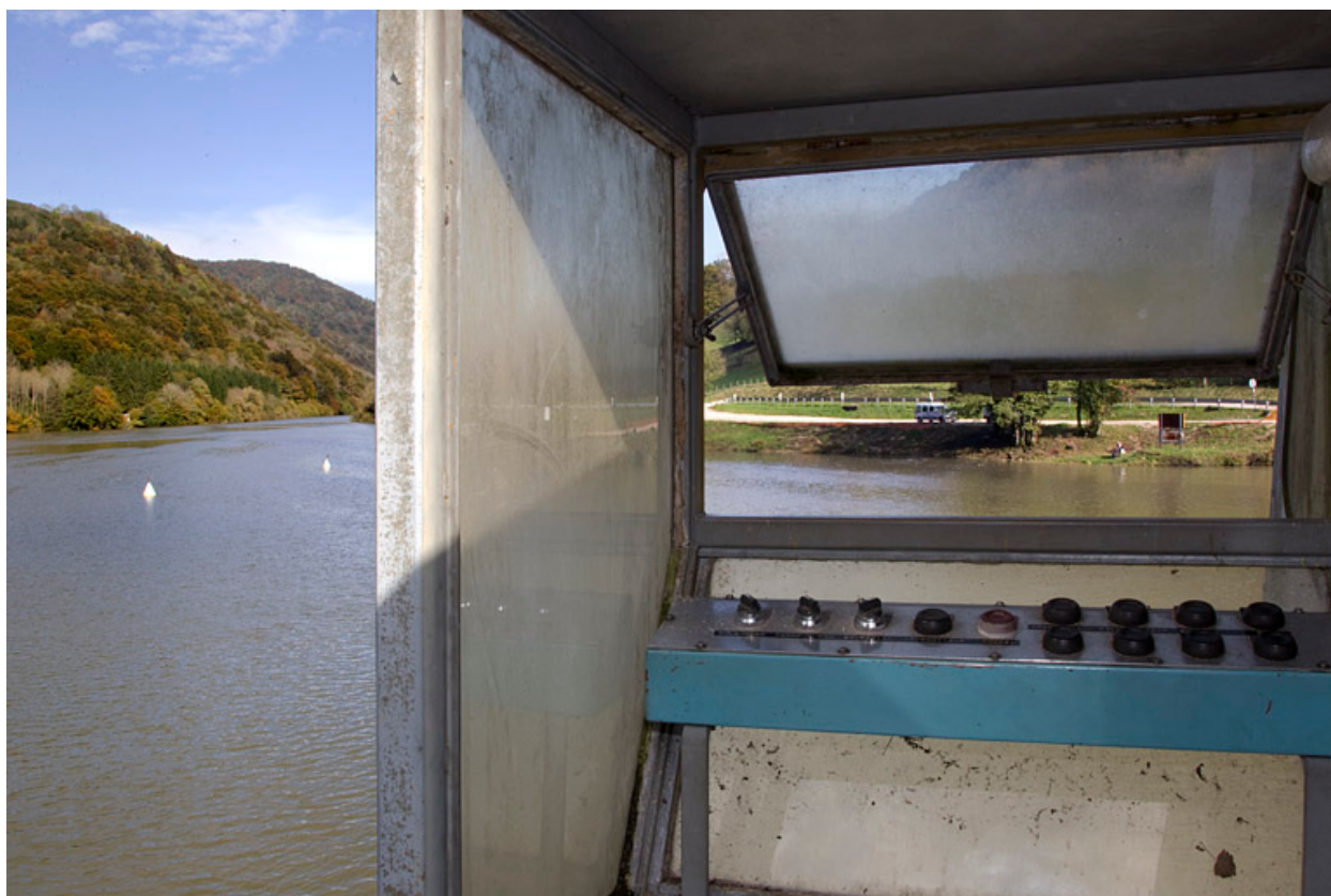
Prise d'eau : poste de commande du dégrilleur.
