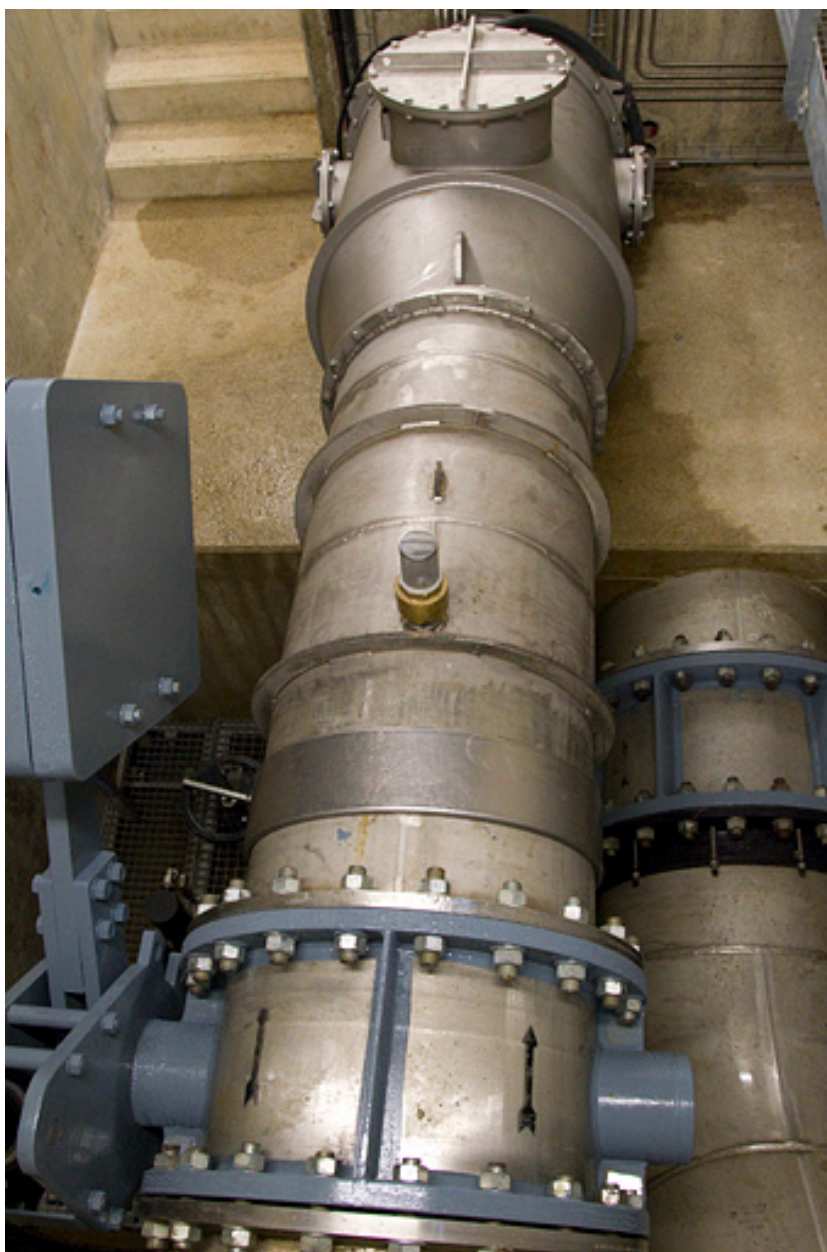
Centrale : nouveau groupe de restitution (vue plongeante).
