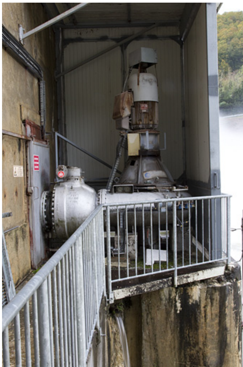
Centrale : ancien groupe de restitution.
