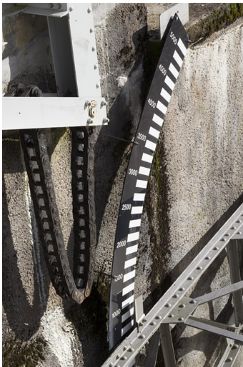
Barrage : repère mesurant l'ouverture d'une vanne secteur.
