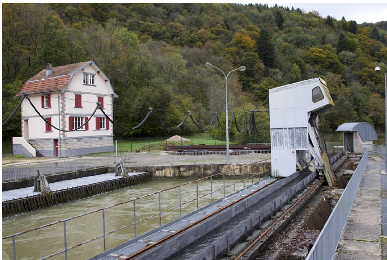
Prise d'eau : vue d'ensemble du dégrilleur.
