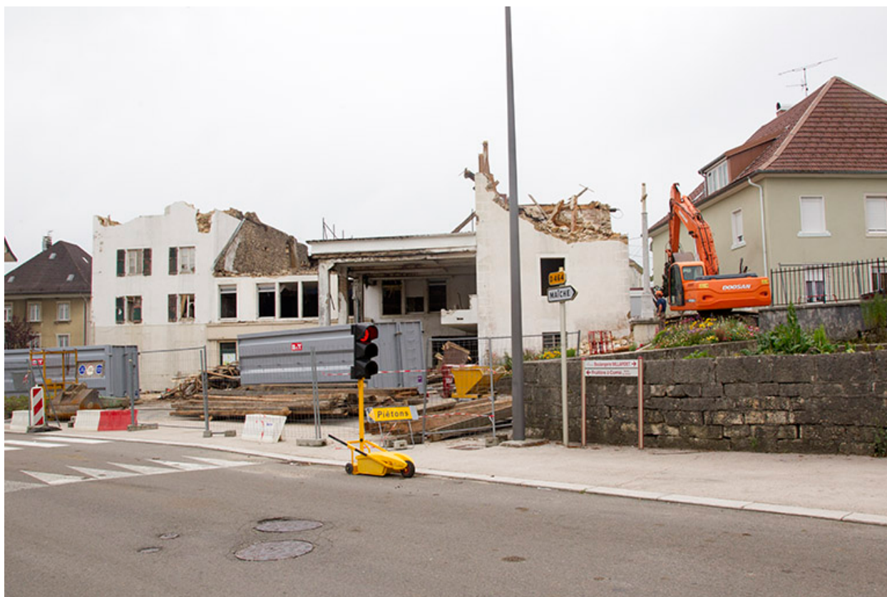
Destruction des bâtiments, 5 septembre 2012 : façades nord.
