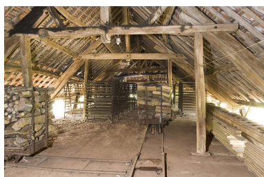
Pièce de séchage. Phot. Jérôme Mongreville IVR43_20087000790NUC2A
