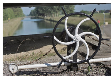
Mécanisme de porte. Phot. Thierry Kuntz IVR26_20112103022NUC2A
