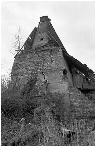
Vue du four de trois quarts gauche. Phot. Jack Dumont IVR43_19797000448Z
