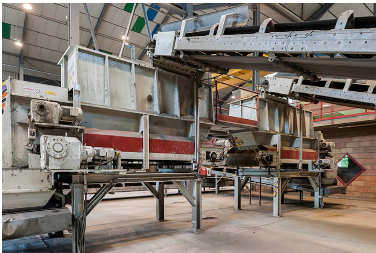
Unité de préparation des terres. Doseurs-tampon.
